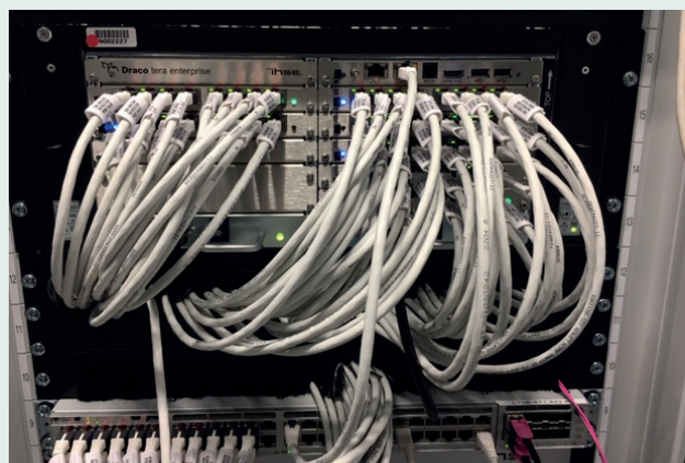
Ein Draco tera enterprise KVM-Switch, Teil eines größeren KVM-Systems
